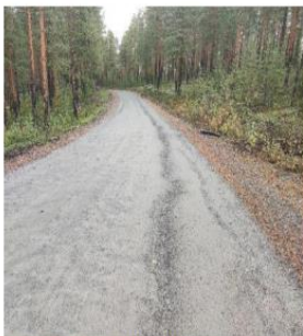
Bild 1. Bristfällig dikning där regnvatten spolat bort delar av vägbanan
